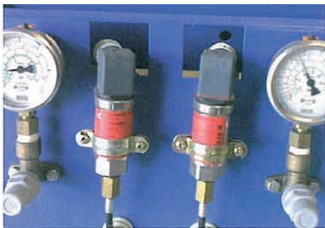
LE PRESSIONI CENTRALE BT
